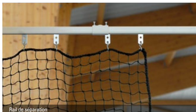
Rail de séparation
